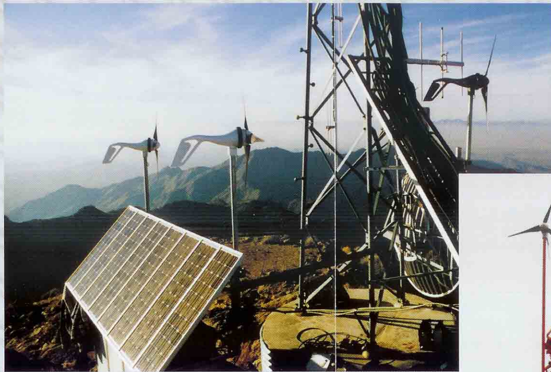
Drei AIR Industrial garantieren die Stromversorgung eines Telefon Transmitters in den Bergen von Phoenix, Arizona, USA.
